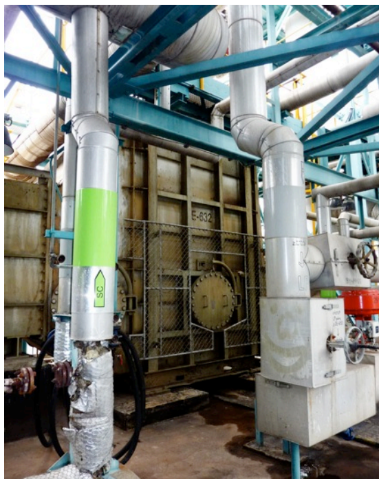
Obr. 4 Výměník V1 – levá strana
