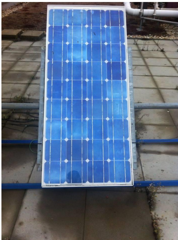
Obr. 0.9: Solární panel A-130 na střeše budovy Technická 10 ve 4. poschodí
