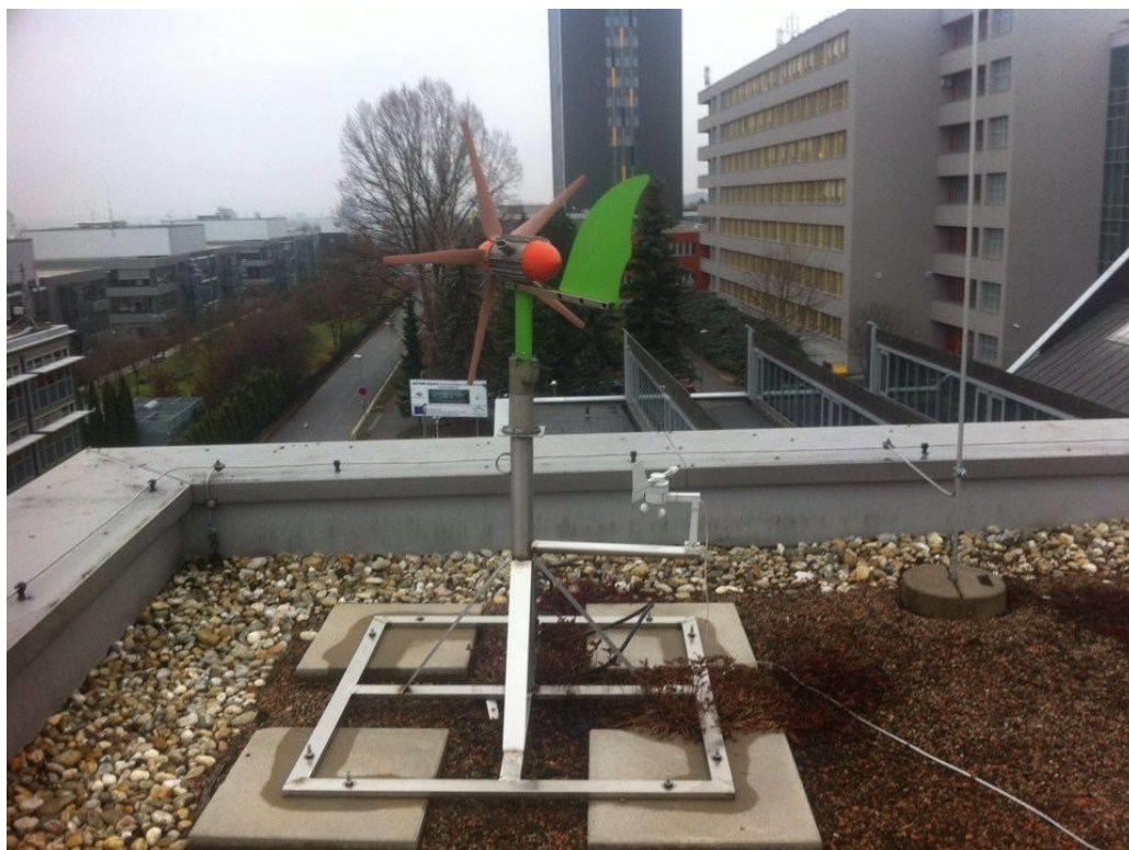
Obr. 0.8: Větrná turbína JPT100 na střeše budovy Technická 10 ve 4. poschodí
