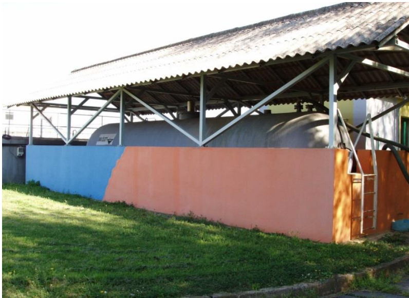
Obrázek 6: Stanice chemického srážení fosforu ČOV Hodonín [foto: Milan Herka]
