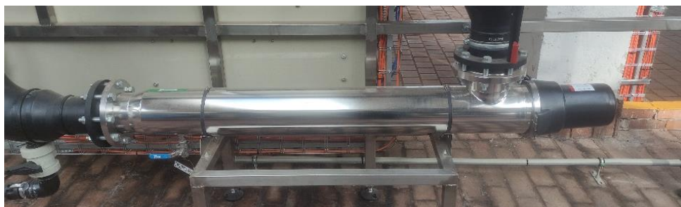
Obrázek 14 UV filtrace v JE Temelín na vstupu do RO
