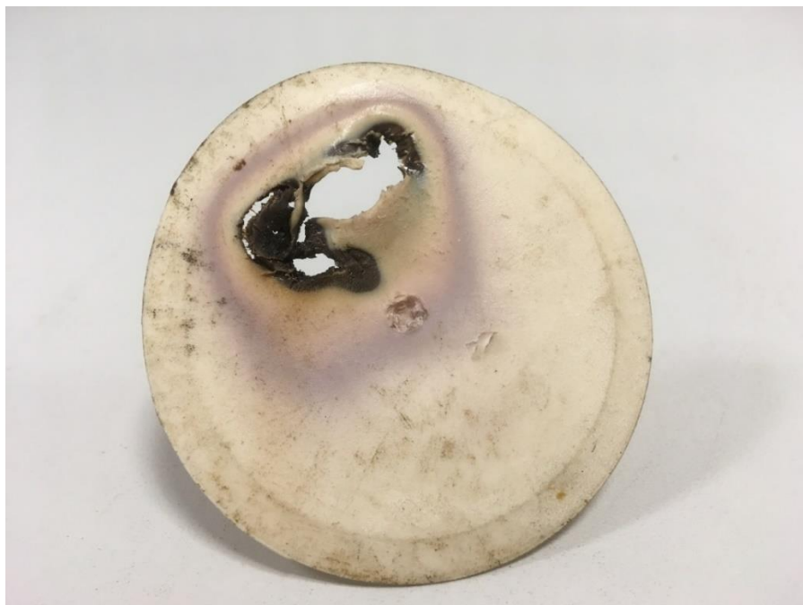
Obr. 4.3 Závada na krytu instalační krabice pod omítku
