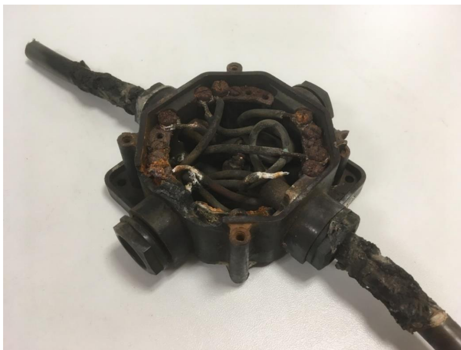
Obr. 4.4 Závada na instalační krabici na omítku
