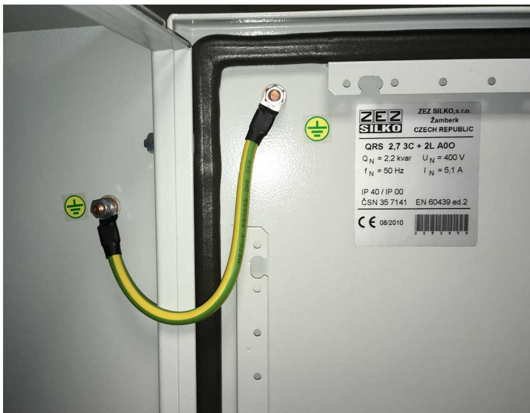
Obr. 5.10 Šroubové spoje ochranného pospojení rozváděče QRS 2,7 3C +2L A00
