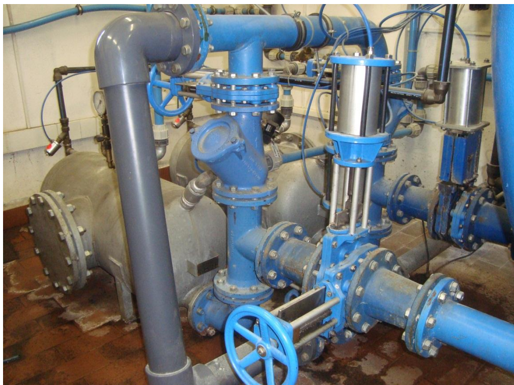
Obr. 17: Tlakové nádoby s potrubím a armaturami [zdroj: Lazur]
