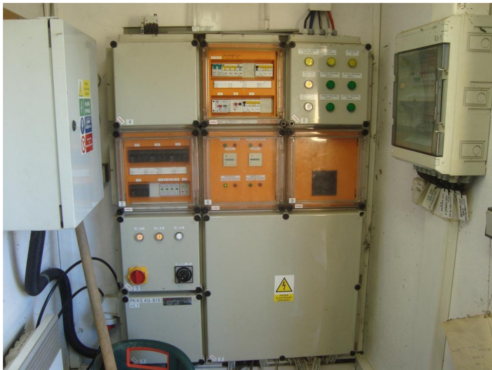
Obr. 15: Řídicí a ovládací jednotka s rozvaděči [zdroj: Lazur]
