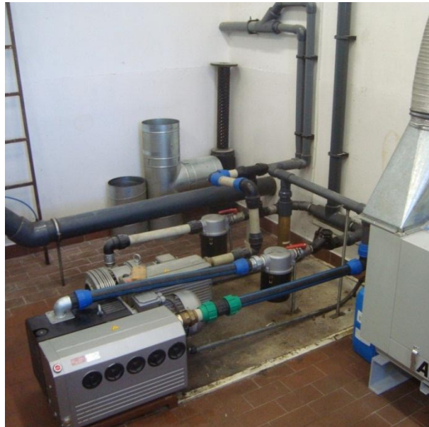
Obr. 21: Vývěvy RIETSCHLE VCAH 160 [zdroj: Lazur]
