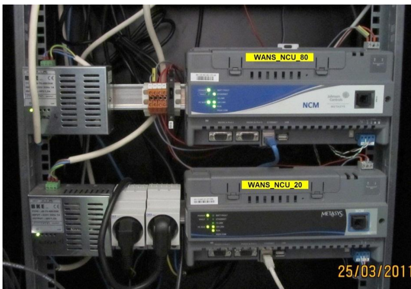
Obrázek 4: Ukázka osazení převodníků NCM (Zdroj: Teplárny Brno)
