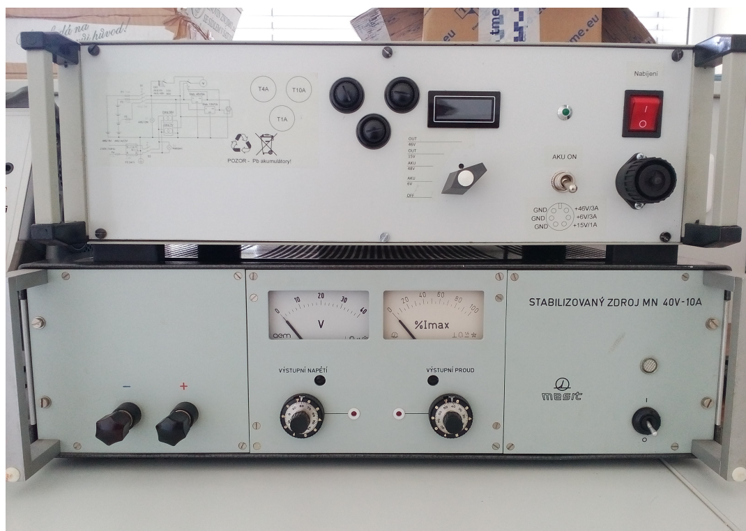
obr. 4.13 Hore realizovaný akumulátorový napájecí zdroj, dole stabilizovaný zdroj 40V/10A používaný na kontinuální mód výkonového zesilovače.
