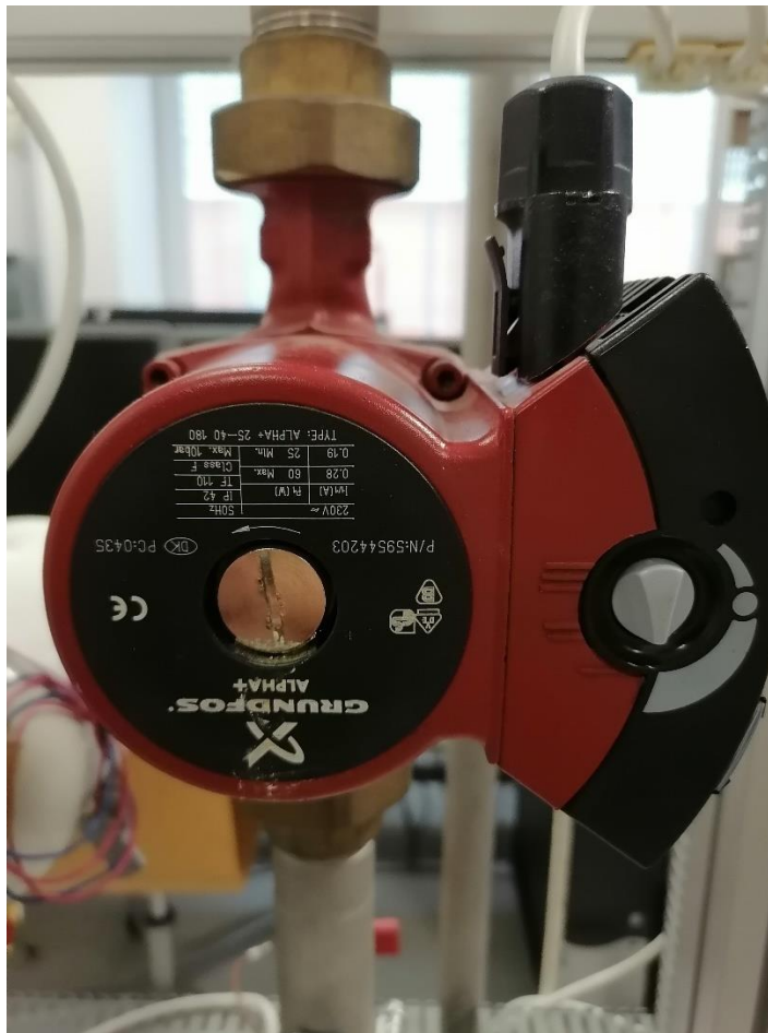
Obrázek 1.4 Čerpadlo pohánějící vodu ve stanici
