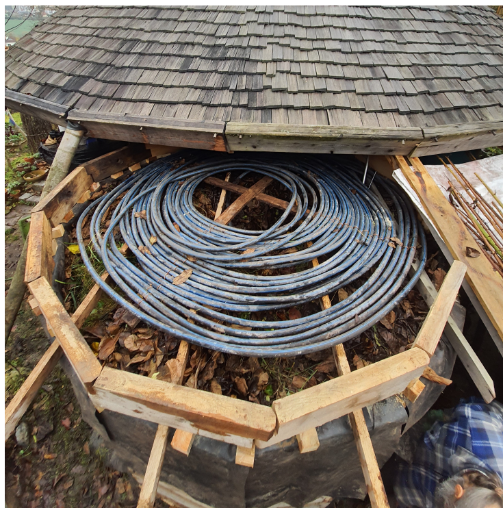
Obr. 5.7: Dovršený bioreaktor s instalovaným kondenzačním výměníkem
