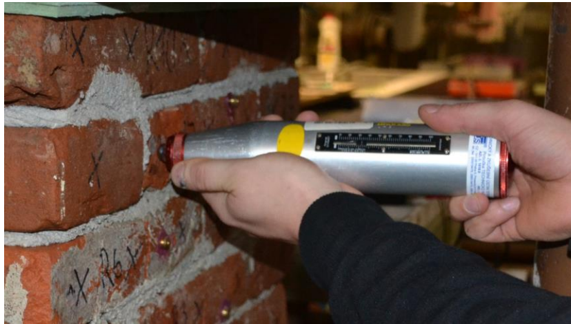
Obr. 24. Stanovení pevnosti v tlaku pomocí tvrdoměrné metody Schmidt LB na cihelném pilíři.
