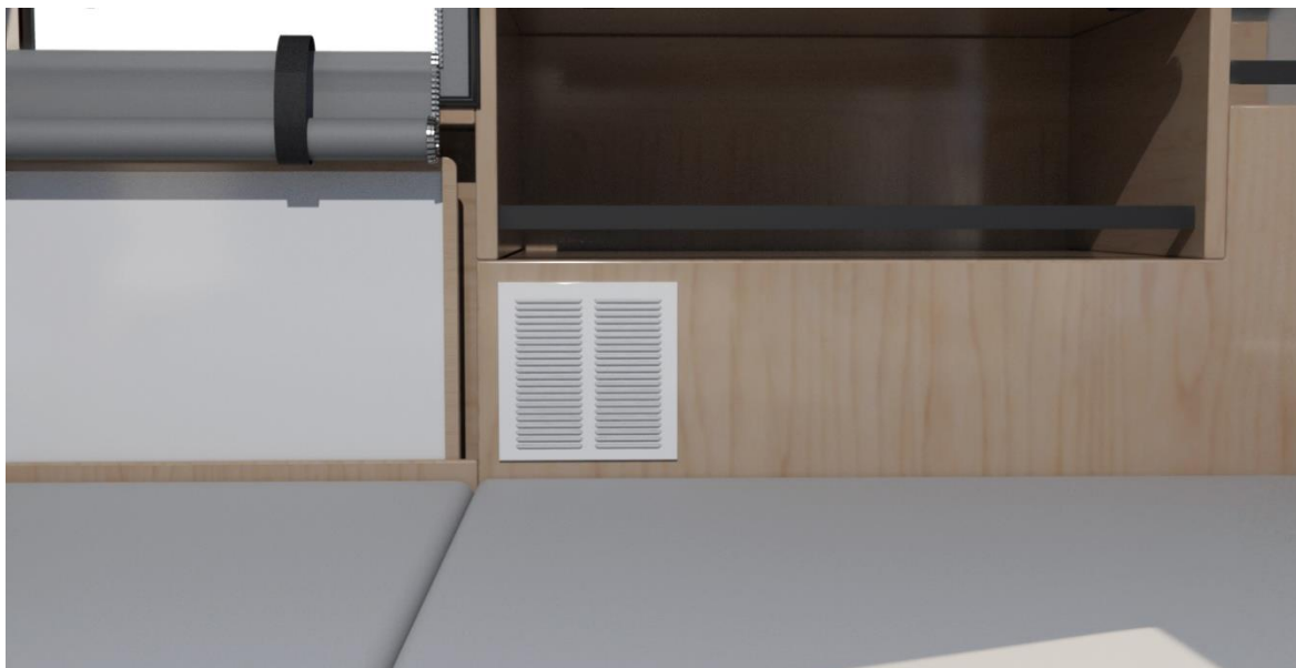
Obr. 6- 12 Mřížka, kterou proudí teplý vzduch do interiéru
