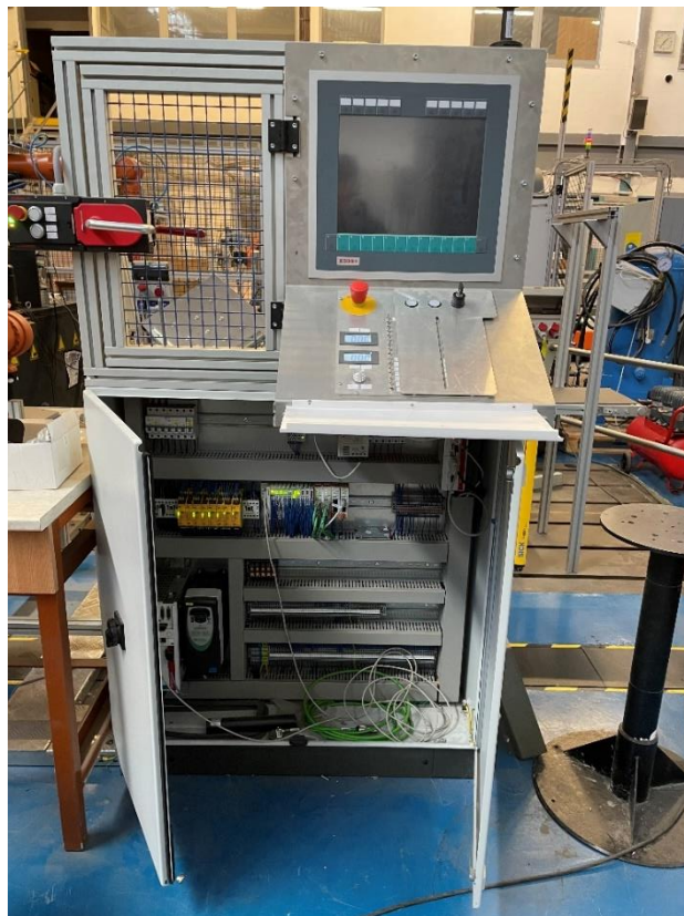
Obr. 16) Ovládací panel a rozváděč
