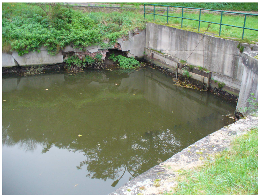
Obrázek 3.9: poškozený nátokový objekt na ÚV Pisárky (viz. P.14)
