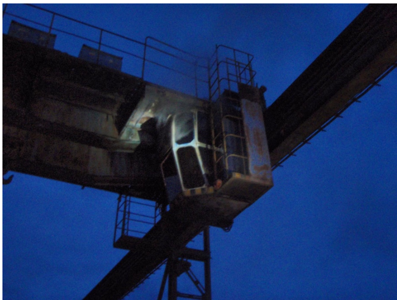
Obr. 24) Ukázka ohořelé kabiny mostového jeřábu [54]
