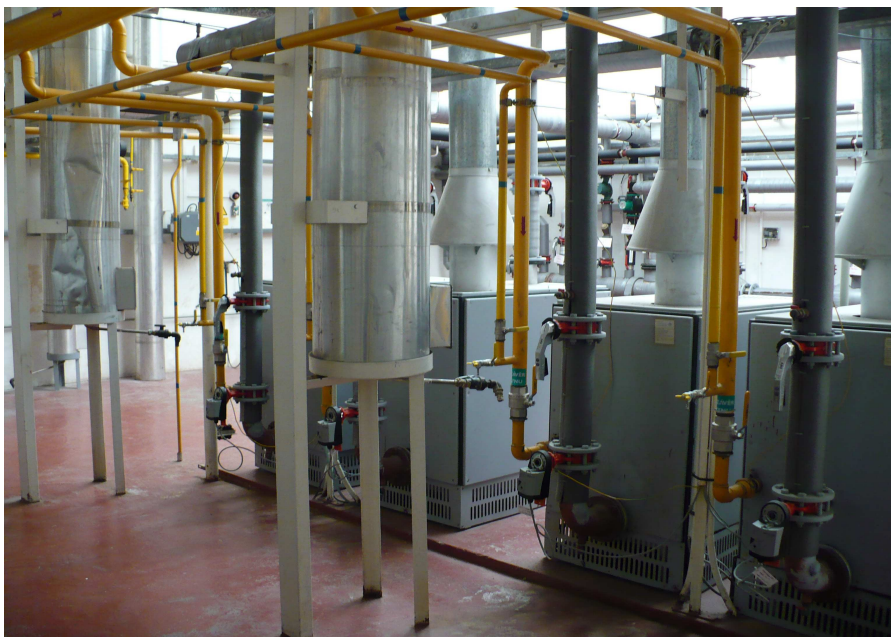
Obr. 4-2 Pohled na zadní část Centrální kotelny se čtyřmi plynovými kotly HOTERM 120 ES
