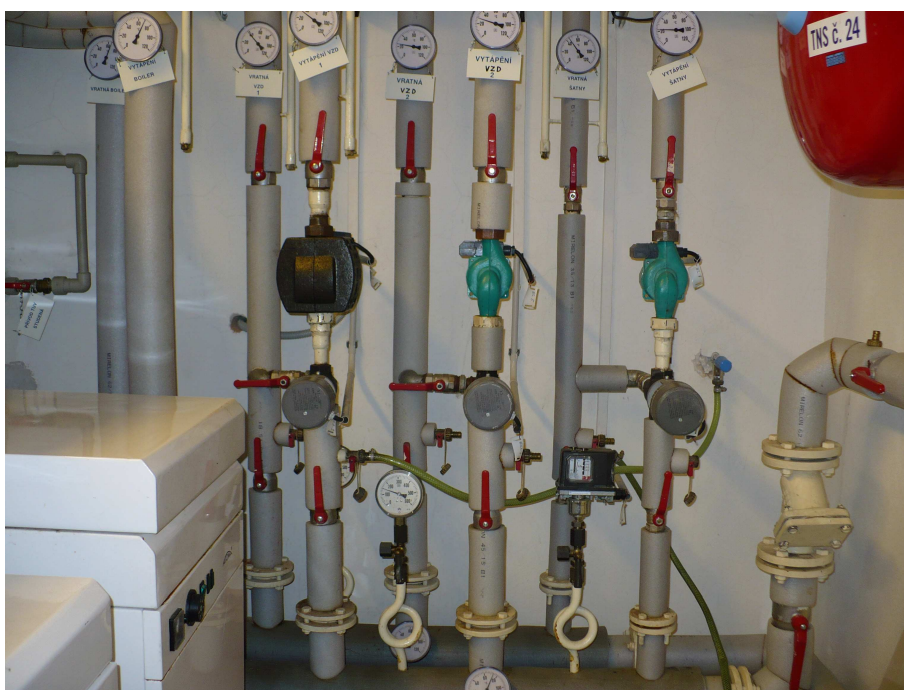
Obr. 3-10 Ukázka rozvodu lokální kotelny pro sklad MTZ, dílnu údržby, elektro údržby a šaten
