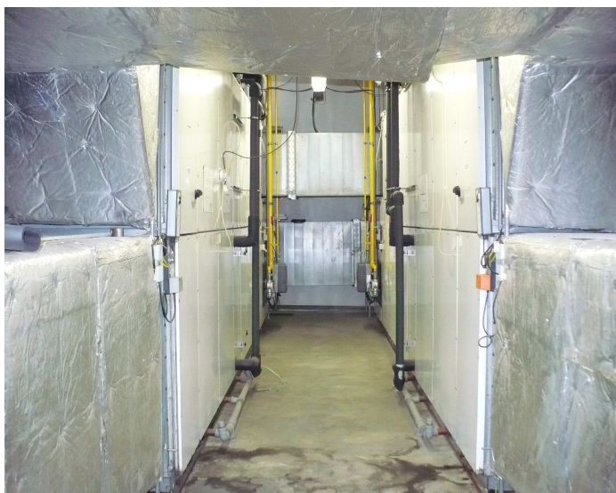
Obr. 3-14 Strojovna VZT - zařízení s přímým ohřevem vzduchu pro dílnu Tisku
