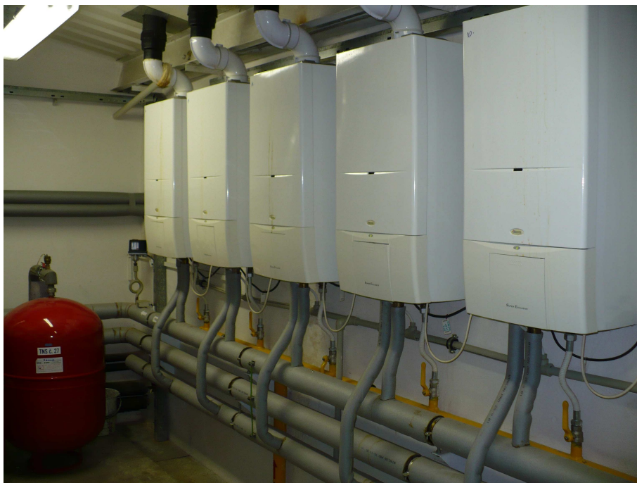
Obr. 3-3 Kaskádově zapojené kotle pro dílnu řásnění WP I
