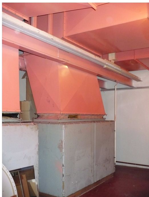
Obr. 3-15 Klimatizační komory odvodní větve VZT jednotky pro dílnu Úpravny
