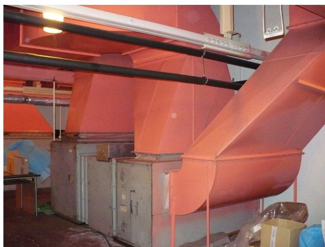
Obr. 3-16 Klimatizované komory přívodní větve VZT jednotky s výměníkem pro dílnu Úpravny
