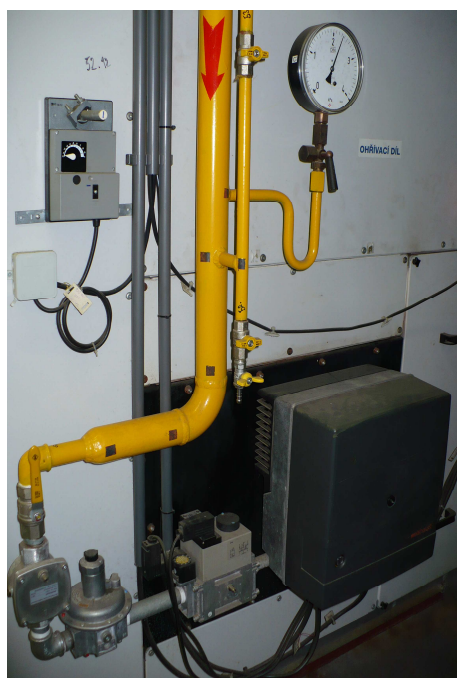
Obr. 3-13 Plynová komora osazená plynovými hořáky Weishaupt
