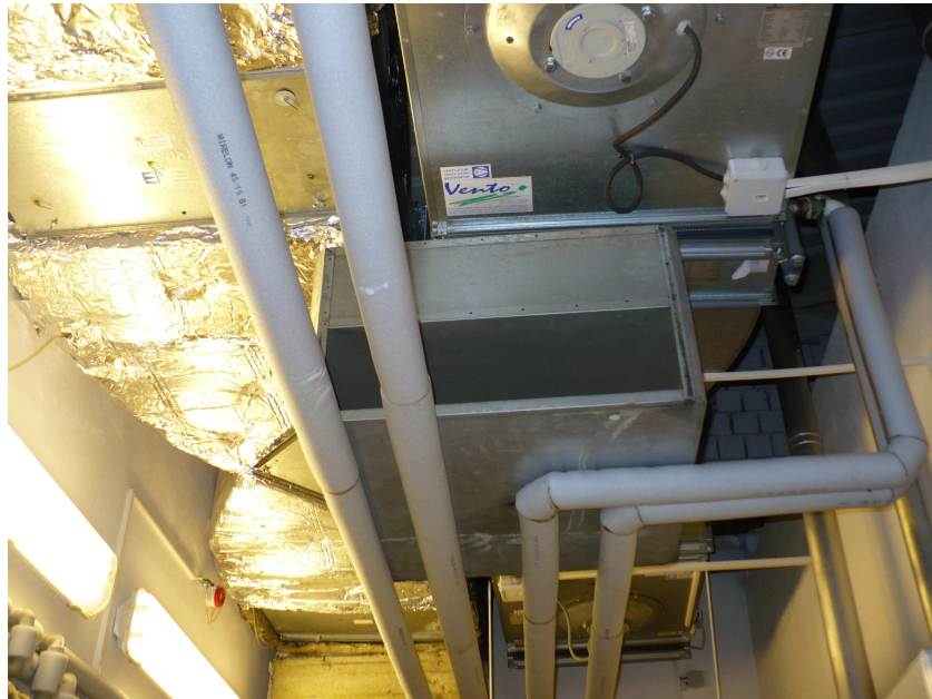
Obr. 3-12 VZT pro prostor šaten umístěná v podstropní části kotelny
