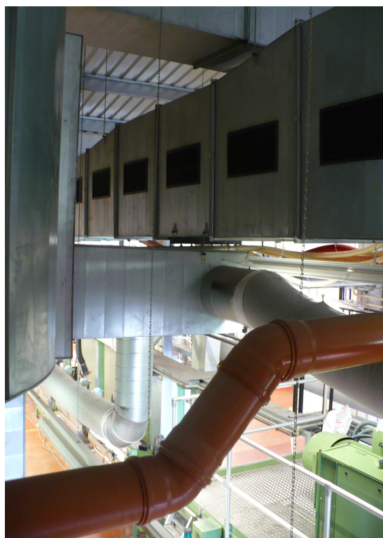
Obr. 3-1 Pohled na rozvody VZT po dílně Extruze
