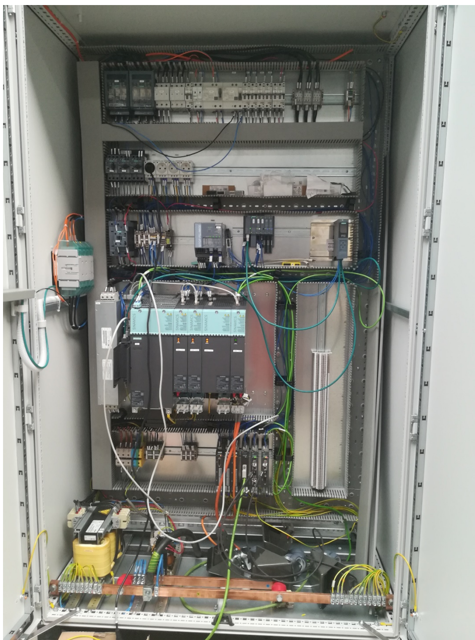
Obrázek 4.1 Vnitřek rozvaděče se zapojením
