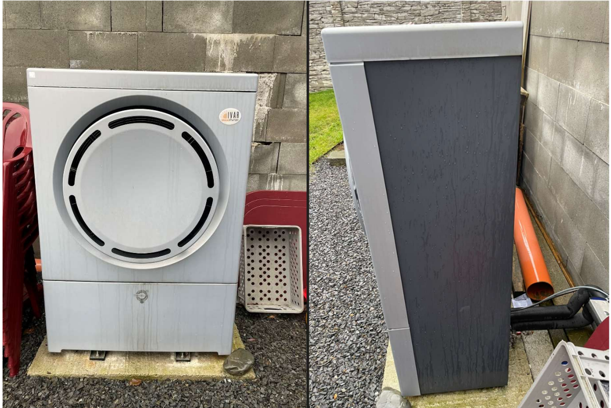
Obrázek 55: Venkovní jednotka tepelného čerpadla IVAR Thermia ATEC
