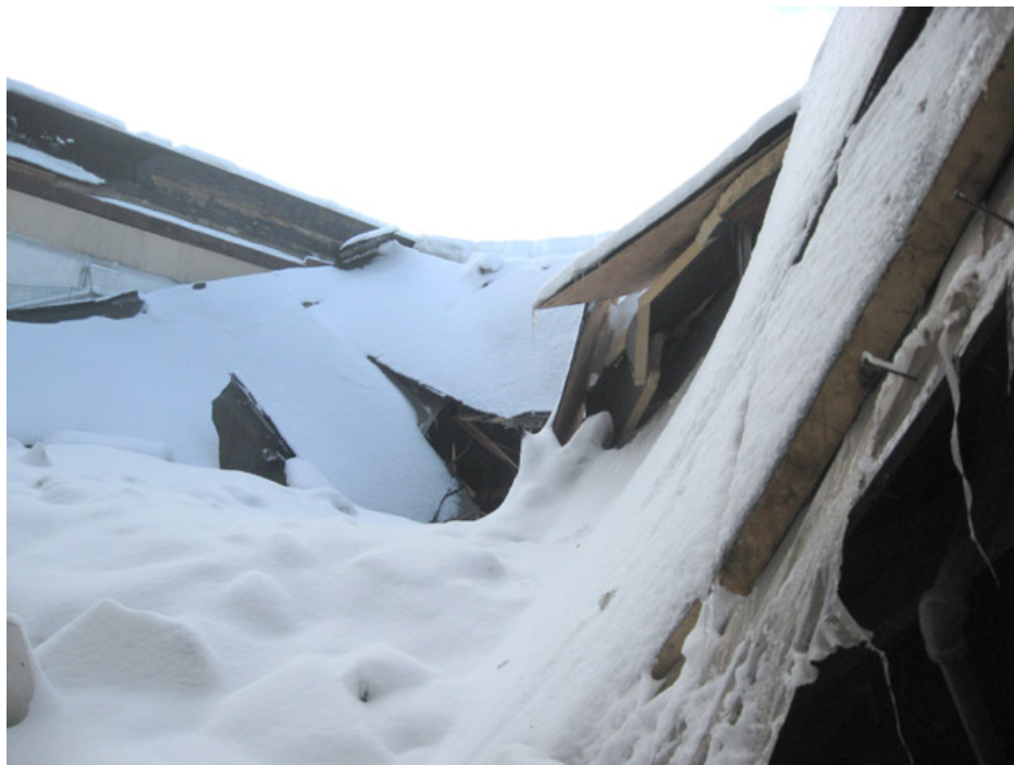
Obr. č. 6-2: Detailní pohled na RD s poškozenou částí střechy způsobenou tíhou sněhu ze dne 5. 3. 2012.
