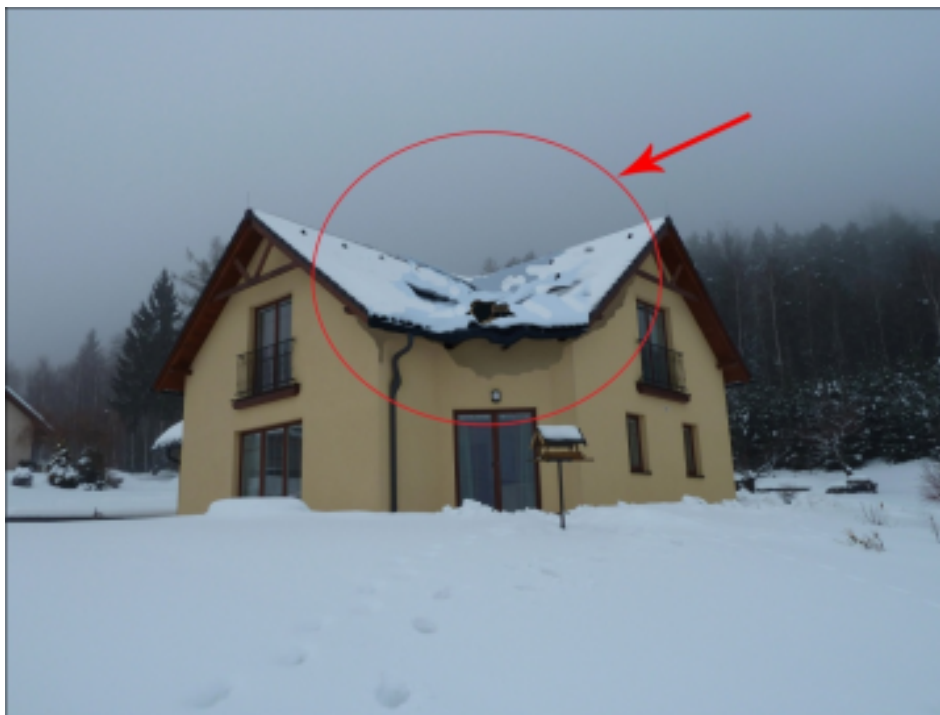
Obr. č. 6-1: Celkový pohled na RD s poškozenou částí střechy způsobenou tíhou sněhu ze dne 5. 3. 2012.
