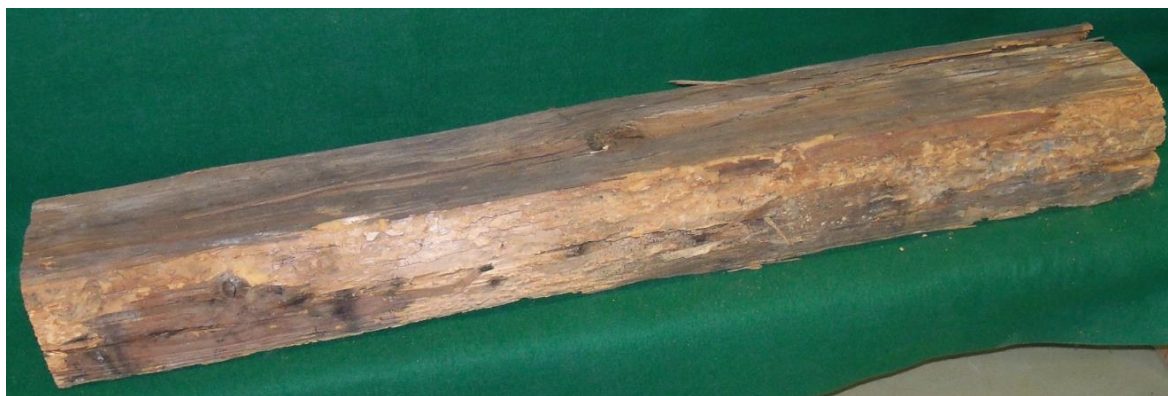
Obr. 25: Pohled na vyříznutý zkoušený trám
