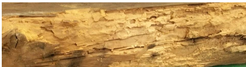
Obr. 24: Detail poškození tesaříkem
