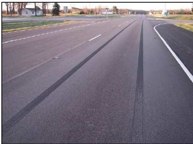
Obr. 65: Blokovací stopa vozidla na asfaltě
