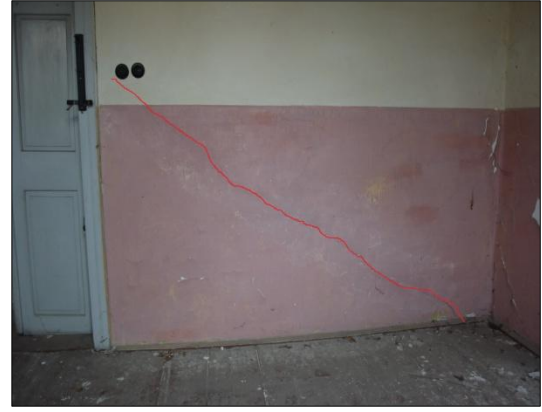
Obr.29 Trhliny T6-šířka obou trhlín je až 4mm
