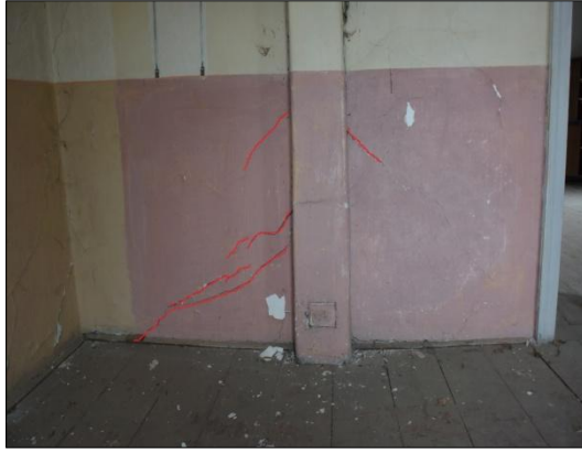
Obr.28 Trhliny T6 způsobené sedáním komínu a průhybem stropu
