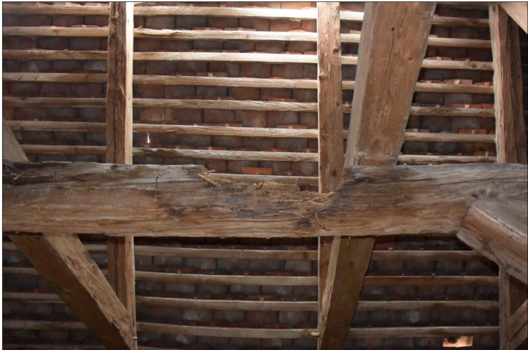
Obr.47 Střední vaznice ve velmi ztrouchnivělém stavu-napadení škůdci a působení vody
