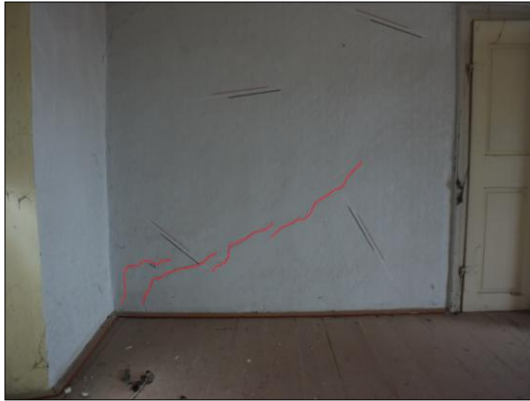
Obr.30 Pohled na trhliny T6 z vedlejší místnosti-šířka je trhlín 4mm
