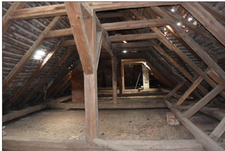
Obr.23 Konstrukce krovu je značně poškozena
