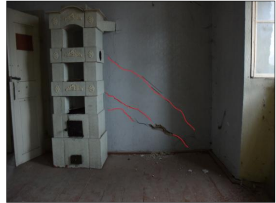
Obr.31 Trhliny T6 – pohled na kamna
