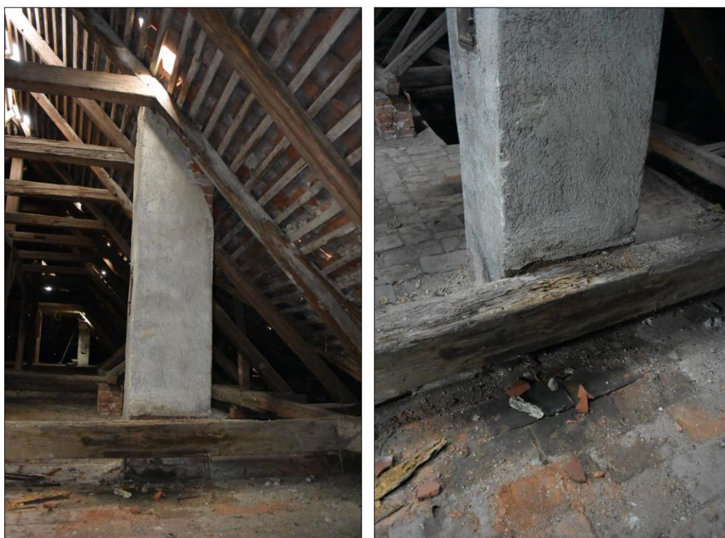
Obr.39,40 Porušení střechy je výrazné a zatékající dešťová voda způsobuje zvýšenou vlhkost a oslabuje konstrukční prvky krovu
