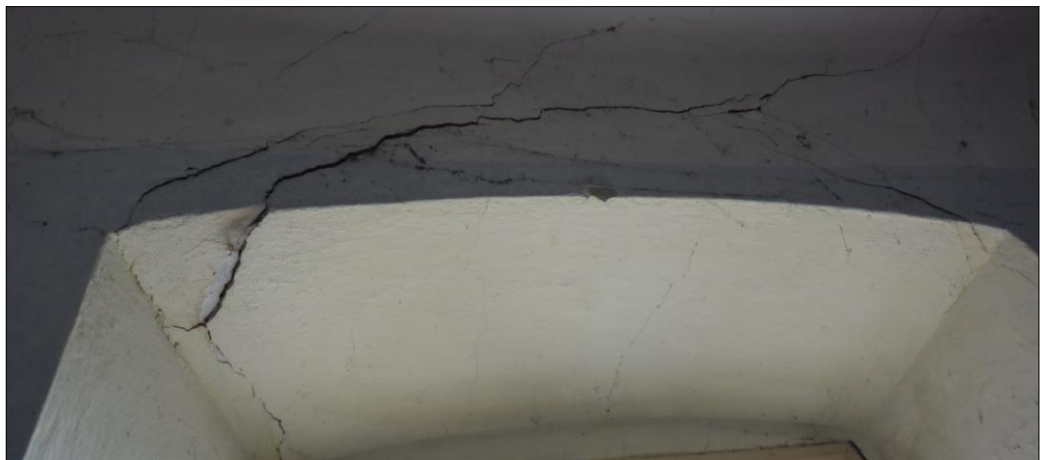
Obr.32 Trhlina T7 v nadpraží zapříčiněná tlakem krovu
