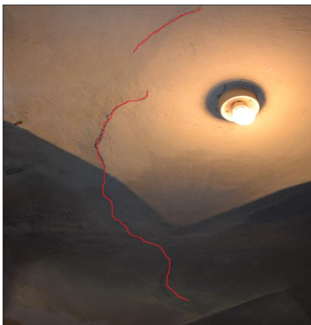
Obr.27 Trhlina T4 – pohledová trhlina šířky 1mm-prostupuje vrcholem klenby-nemá vliv na statické působení konstrukce.
