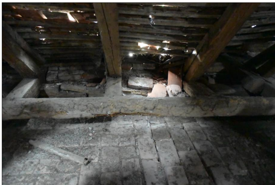
Obr.38 Krov byl v minulosti napaden škůdci, nenese však velké známky poškození
