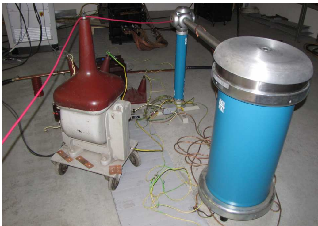
Obrázek 48 Vysokonapět'ový transformátor spolu s normálovým měřicím transformátorem
