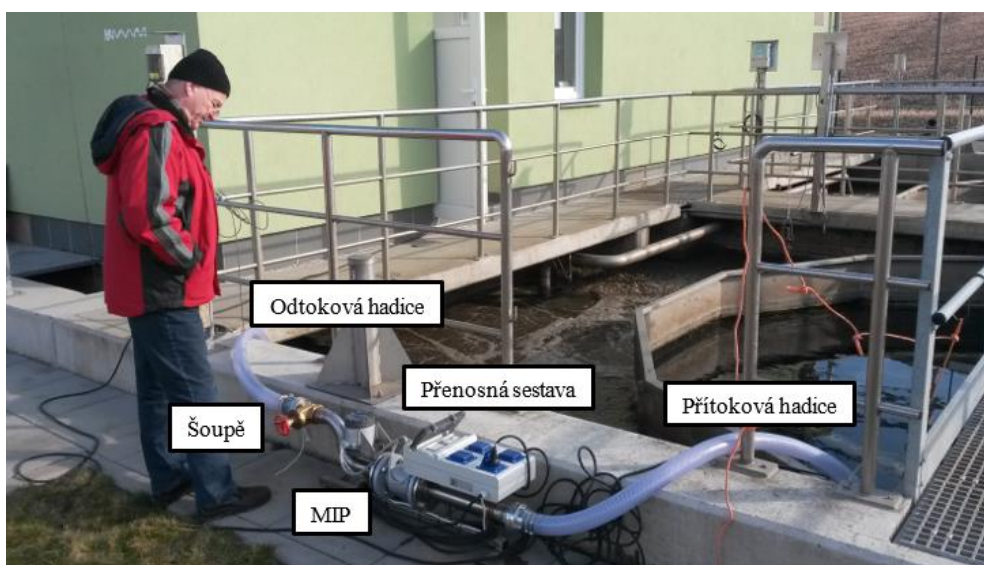
Obrázek 1 Použití přenosné sestavy s indukčním průtokoměrem při praktickém měření, zdroj: [10]
