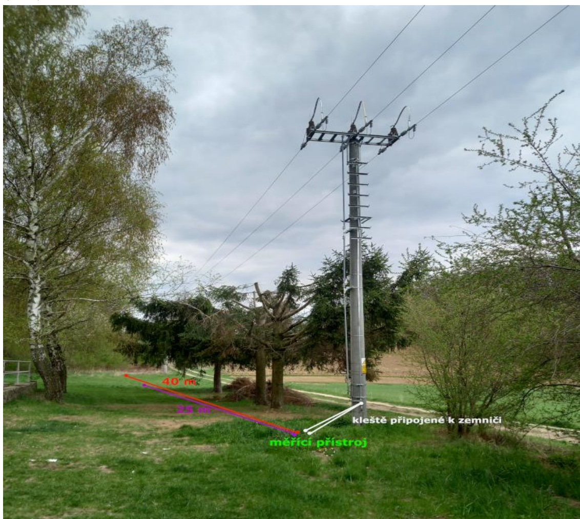
Obrázek 5.17 Měření odporu zemniče u odpojovače 3
