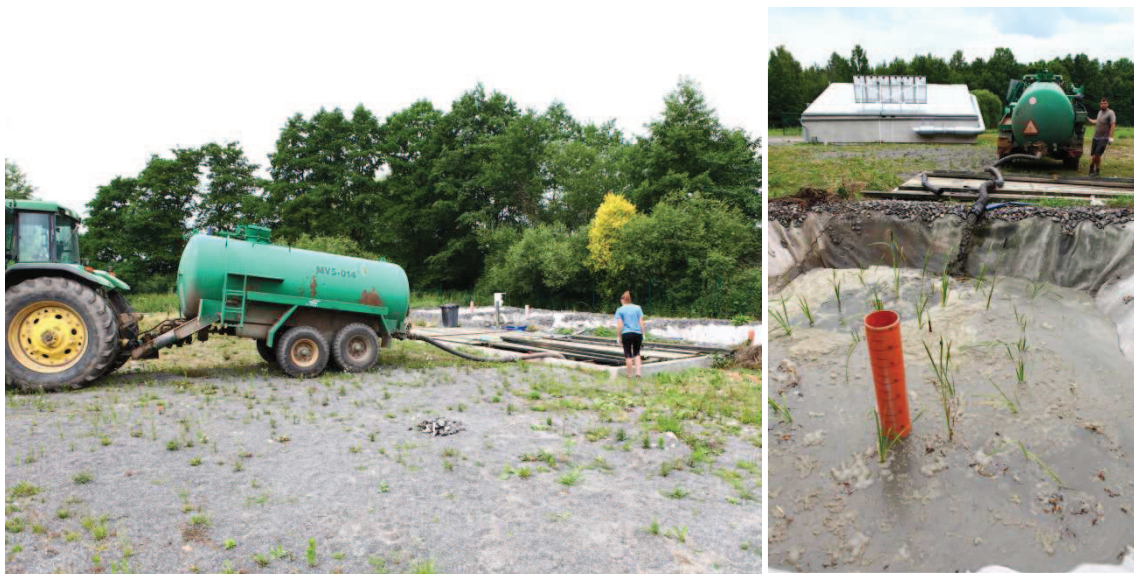
Obrázek 46. Aplikace primárního stabilizovaného kalu na reed-bed systém, ČOV Koteňčice
