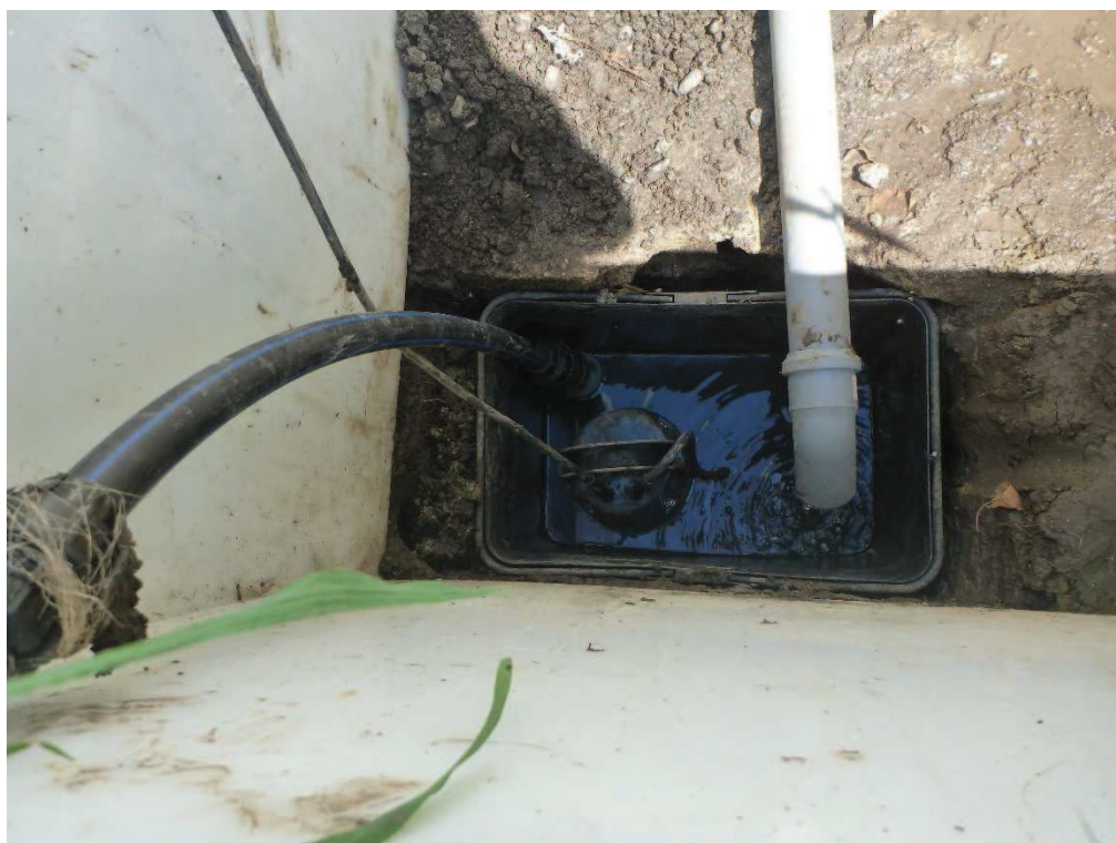
Obrázek 45. Odvod vody drenážním systémem z kalových polí a následné čerpání zpět na ČOV, ČOV Dražovice
