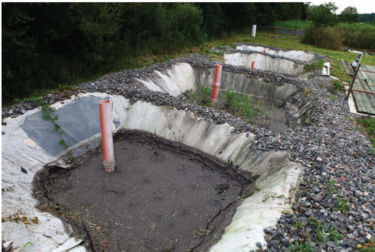
Obrázek 16. Kalová pole na ČOV v Kotenčicích
