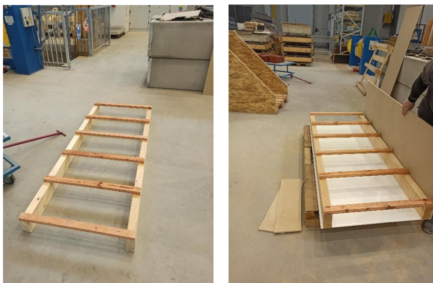
Obr. 24: Příprava modelu střechy: vlevo jsou vidět jen krokve a laťování; vpravo je vidět podbití bílou deskou a chystá se připevňování bočnice
