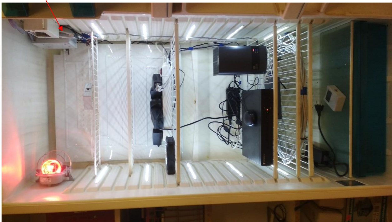
Obr. 29 Vnitřní uspořádání hotové serverovny
