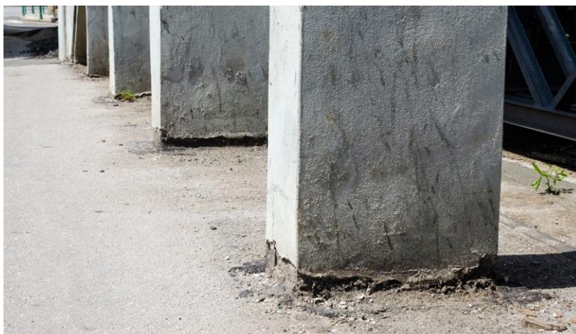
Obrázek 8.11 Poškození spodní části závěsů na levé straně
