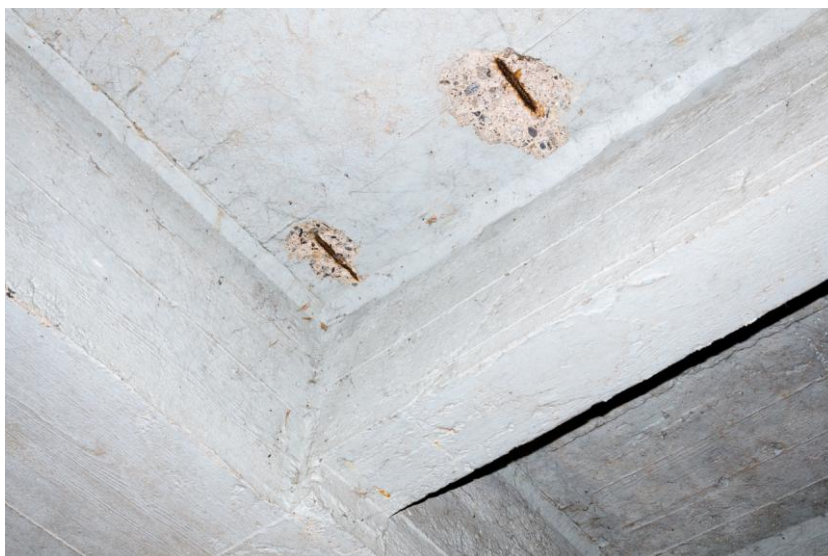
Obrázek 8.12 Odhalená výztuž v podhledu desky mostovky
