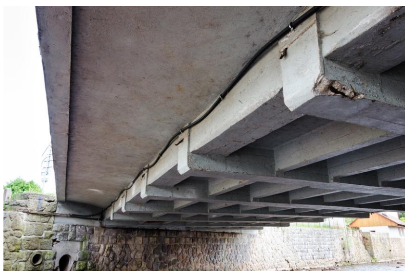
Obrázek 8.14 Konzolová část desky mostovky a odhalená výztuž příčnicku
