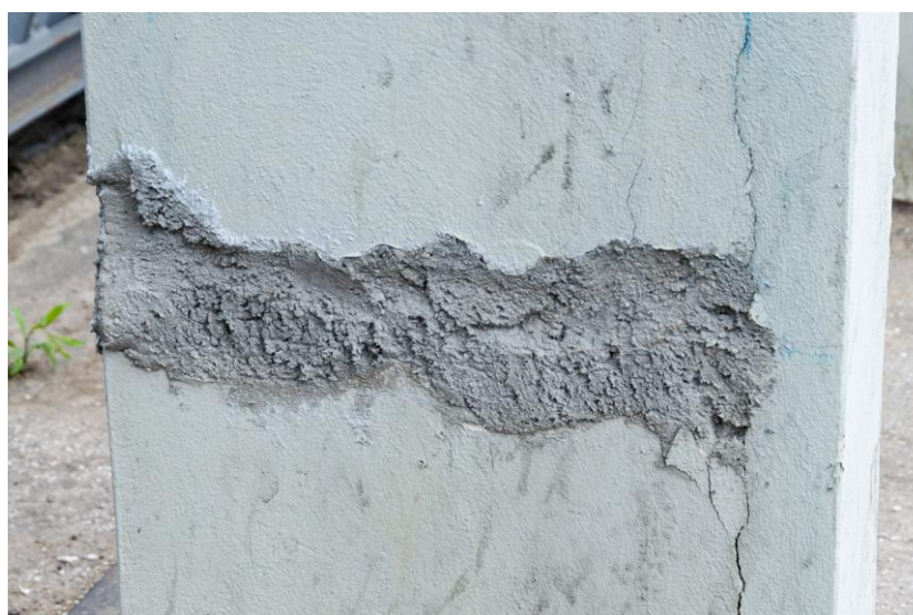
Obrázek 8.24 Pohled na sanaci po sekané sondě S11 s patrnou svislou prasklinou
