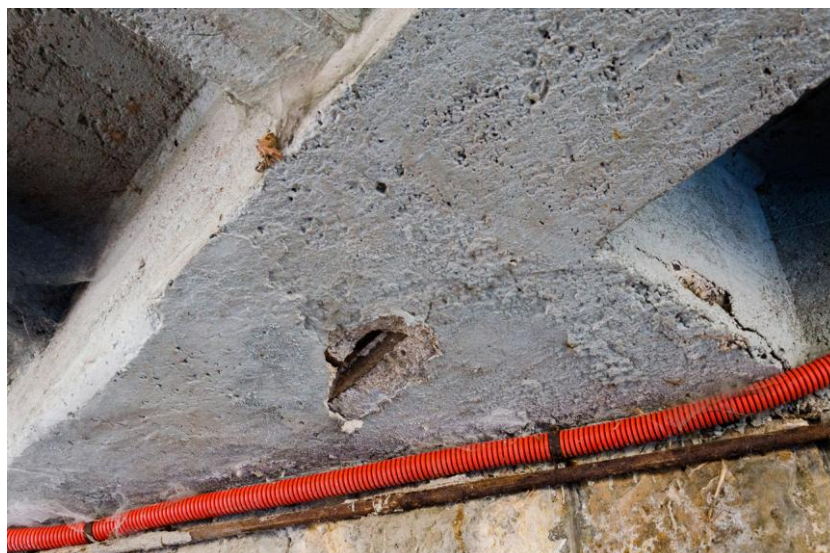
Obrázek 8.16 Poruchy konce krajního příčnicku
