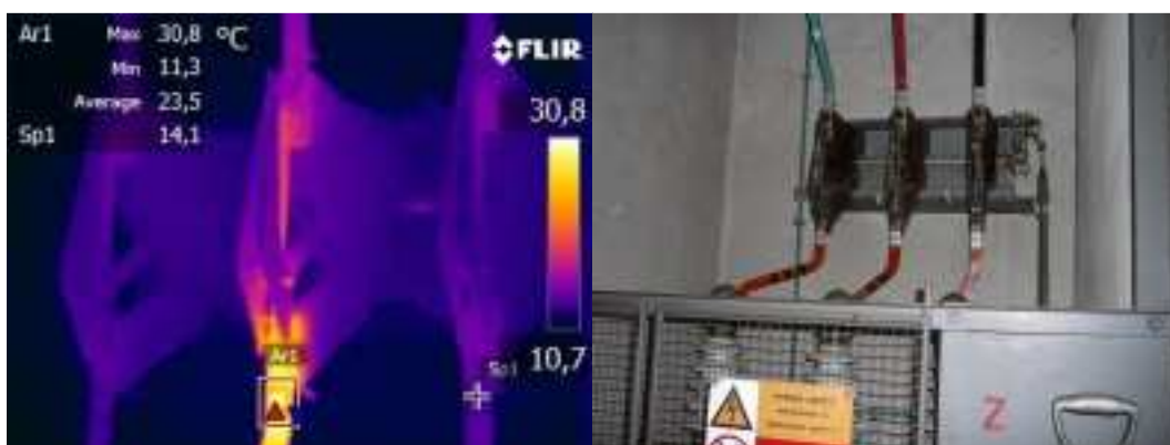
Obr. 0-7 Proudový spoj pásového vodiče a svorníkového oka transformátoru
