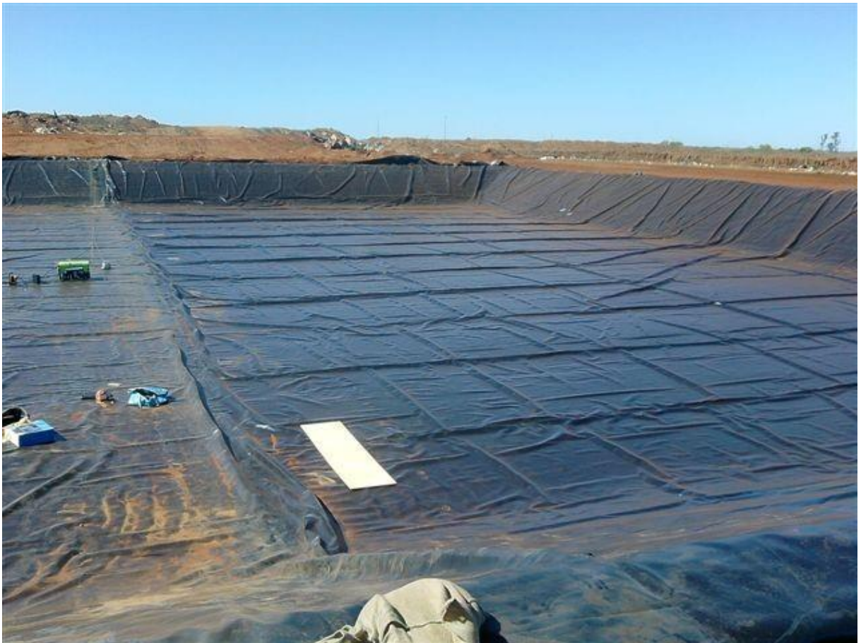
Obr. 7) Fóliové těsnění nádrže [17]
