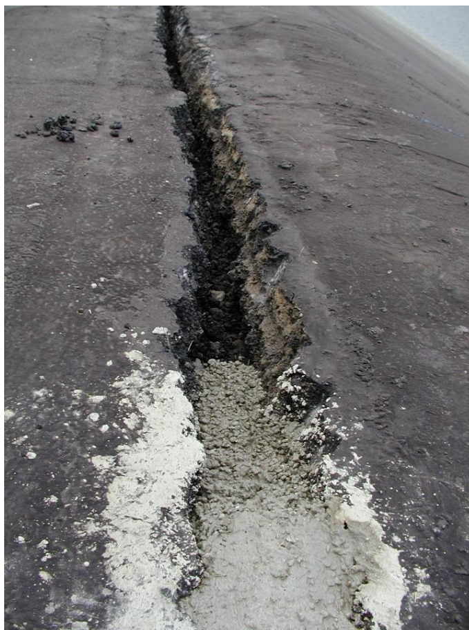
Obr. 12) Ukázka poruchy AB pláště trhlinou vlivem sedání hráze [19]
