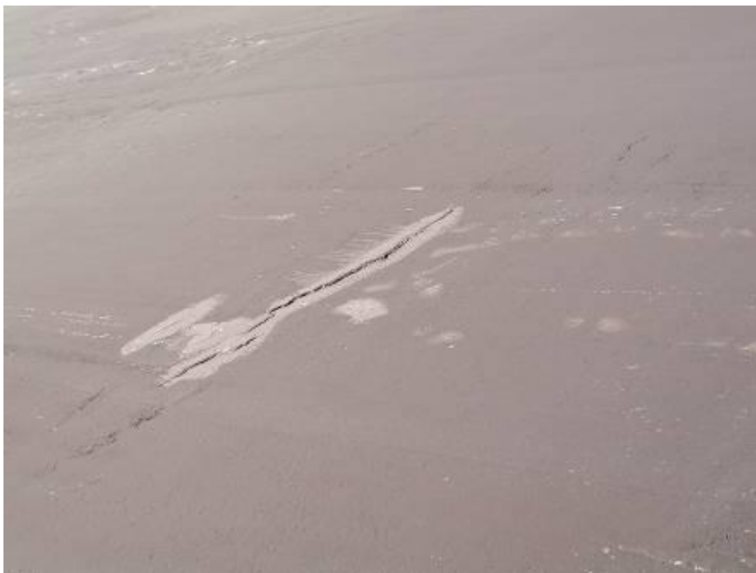
Obr. 14) Ukázka lokální tvorby trhlin [25]
