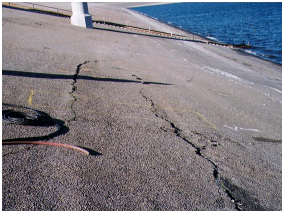
Obr. 13) Ukázka trhlin AB pláště [24]
