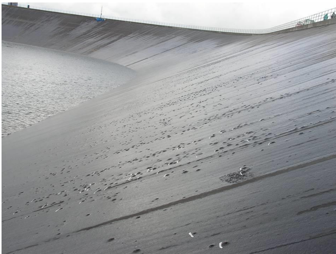
Obr. 15) Příklad plošné poruchy AB pláště [26]
