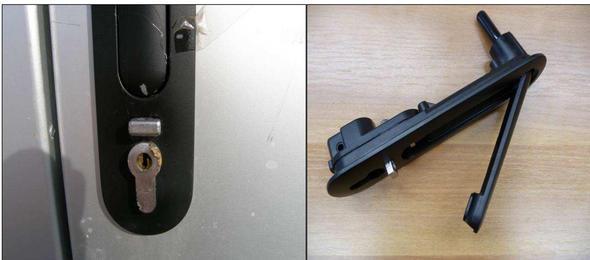
Obr. 2.10 Neúspěšný pokus o vniknutí do objektu
