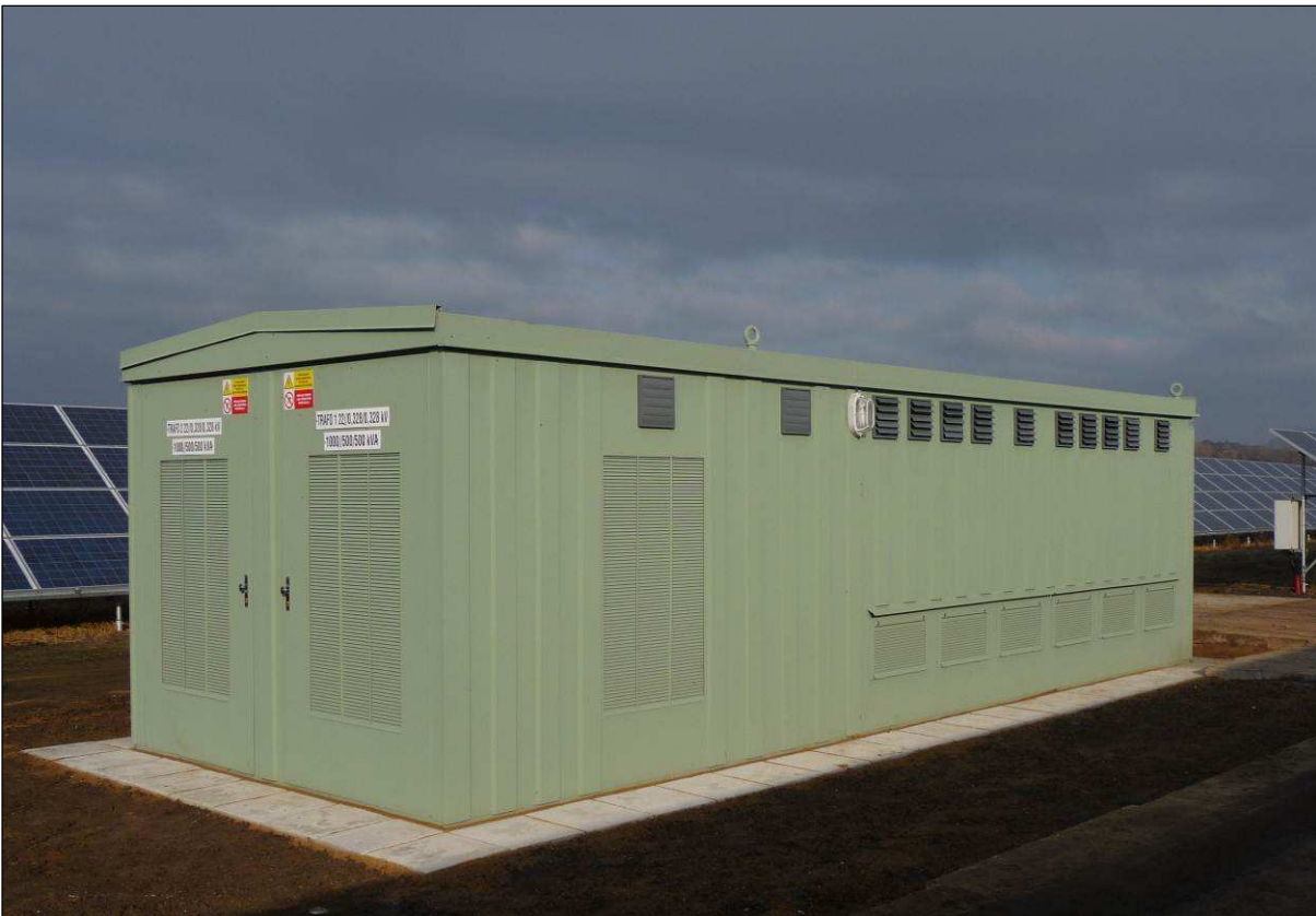
Obr. 2.1 Trafostanice ETS 2 x 1000/střídače Sinvert
