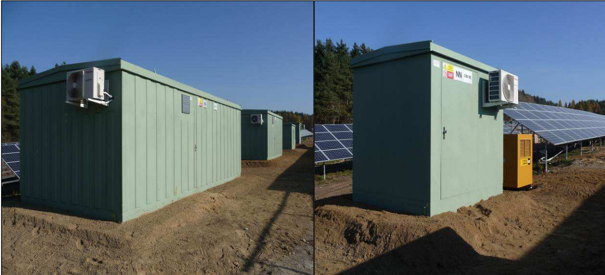
Obr. 2.14 Trafostanice s klimatizací
