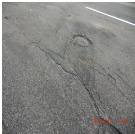
Foto č.31 – trhliny, výtluk, nepravidelné hrboly (km 0,598)
