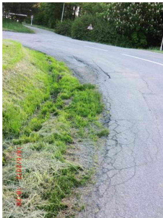
Foto č.29 – odlamování krajnice síťové trhliny, hloubková koroze, vysprávka (km 0,581- 0,598)
