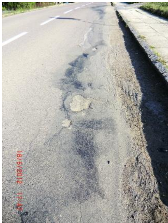
Foto č.15 – výtluk, vyspráva, hloubková koroze (km 0,375)
