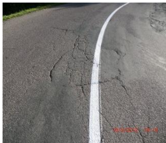
Foto č.23 – síťová trhlina (km 0,492)
