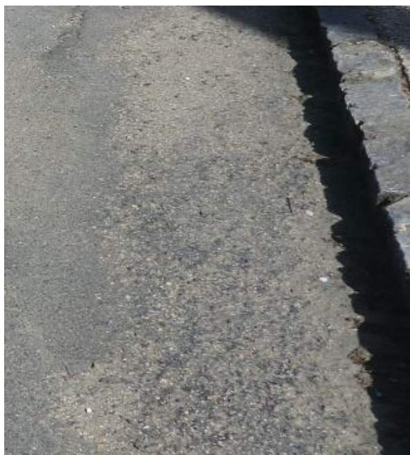
Foto č.7 – hloubková koroze
