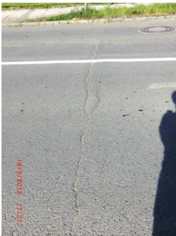
Foto č.1 - trhlina rozvětvená příčná (km 0,025)
