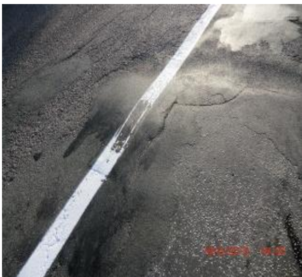
Foto č.28 – nepravidelný hrbol (km 0,514)
