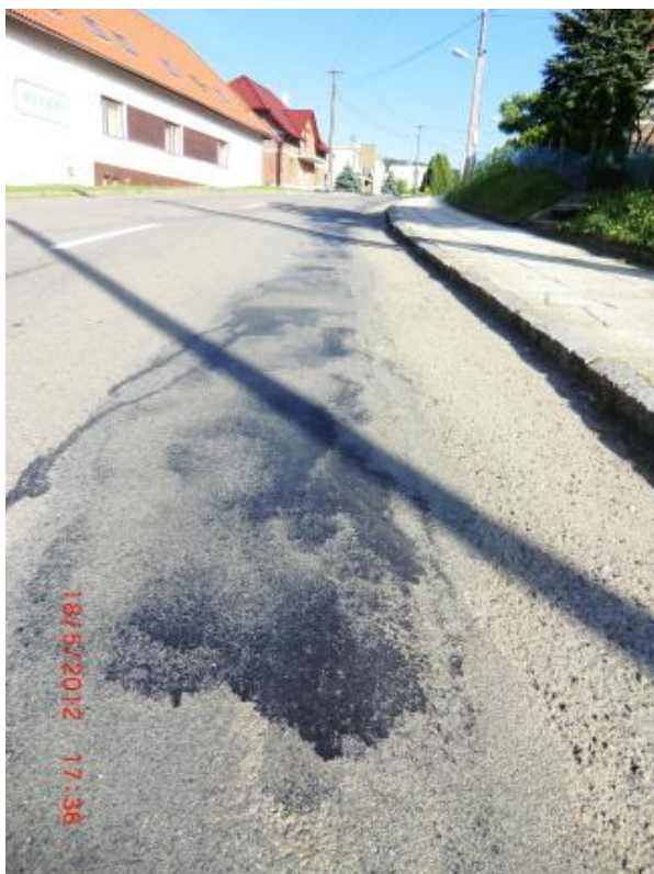
Foto č.9 – vyspráva tryskovou metodou, hloubková koroze
