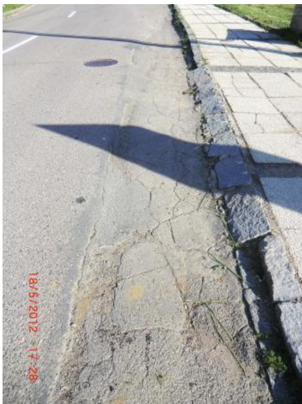
Foto č.5 – trhlina mozaiková (km 0,126)
