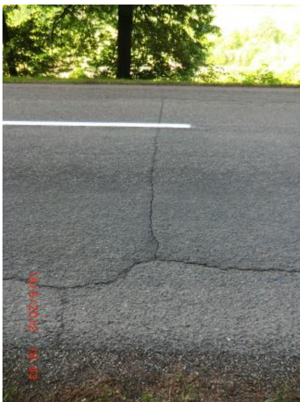
Foto č.37 – spojení trhliny příčné a podélné
