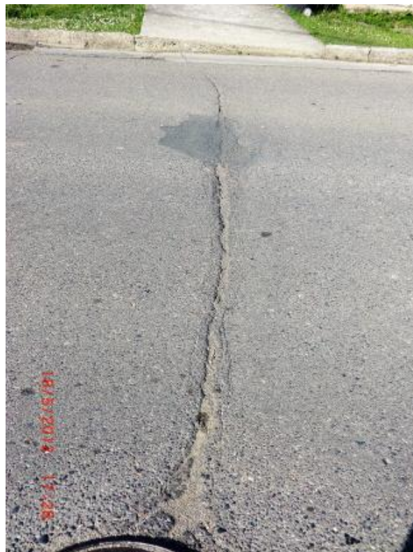
Foto č.6 – široká příčná trhlina (km 0,141)
