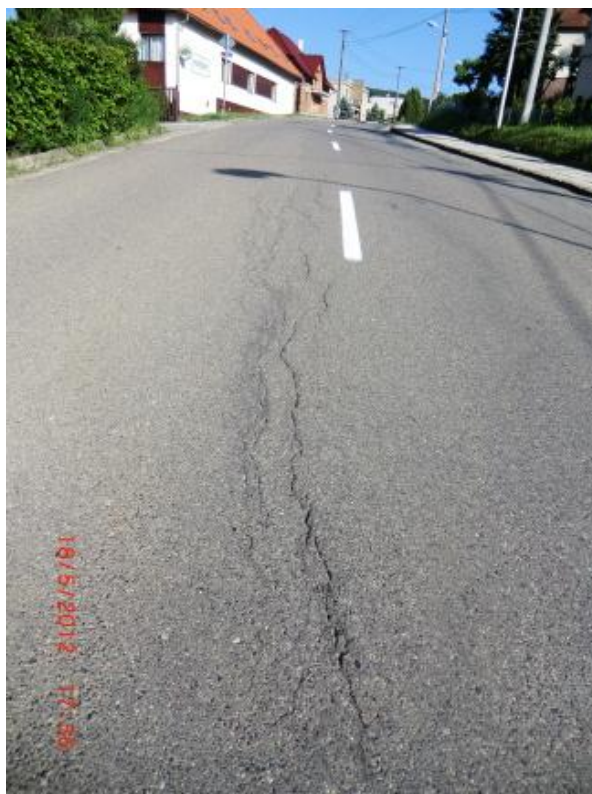
Foto č.8 – trhlina rozvětvená podélná (km 0,146)
