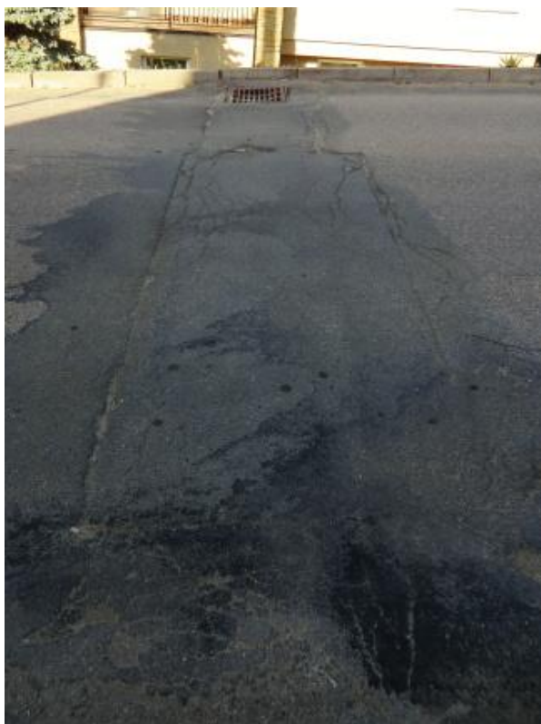
Foto č.11 – trhlina mozaiková, porucha pracovní spáry, propadlá vpust' (km 0,293)
