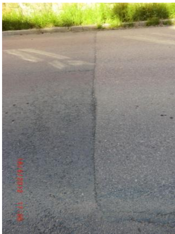
Foto č.4 – trhlina široká příčná (km 0,108)
