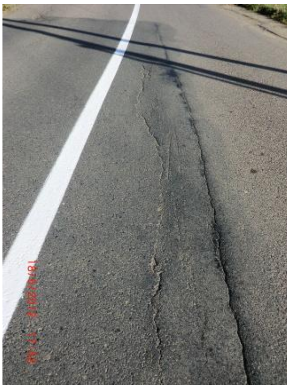
Foto č.20 – široká trhлина podélná, porucha pracovní spáry (km 0,455)
