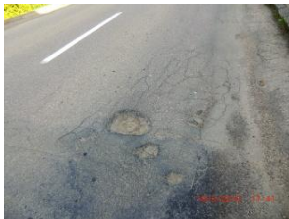
Foto č.12 – výtluk, mozaiková trhlina (km 0,295)
