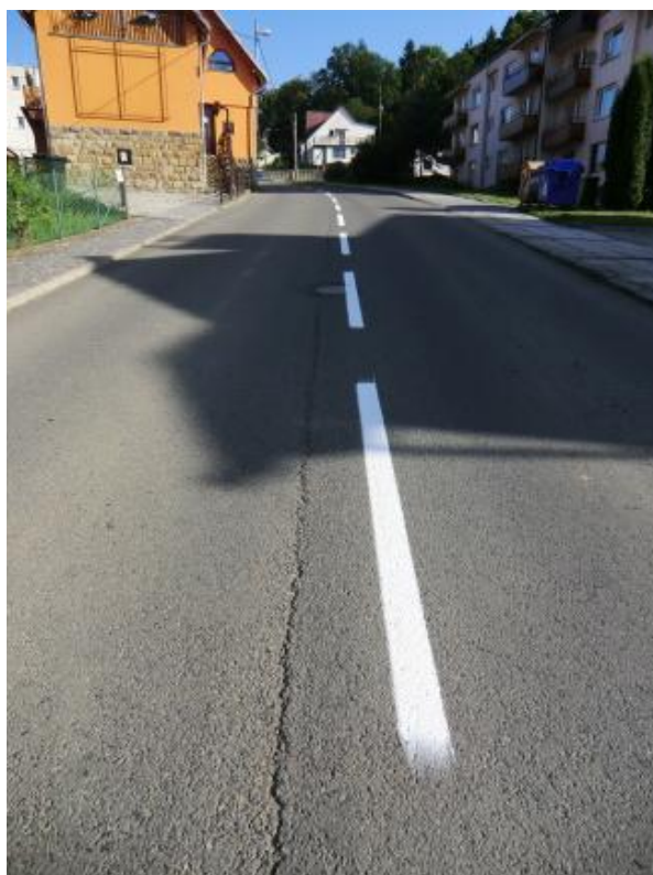
Foto č.3 – trhlina široká podélné (km 0,050-0,100)
