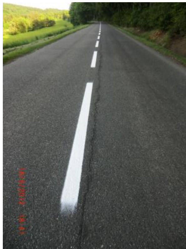
Foto č.36 – široká příčná trhлина
