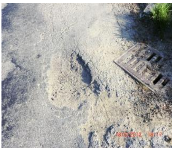
Foto č.22 – výtluk, zanesení vpusti
