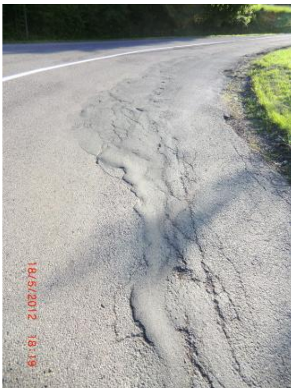
Foto č.24 – síťová trhлина, dochází k usmyknutí vozovky (km 0,495 )
