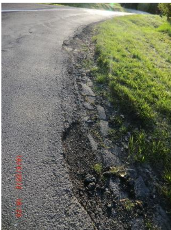
Foto č.26 – odlamování krajnice (km 0,512)
