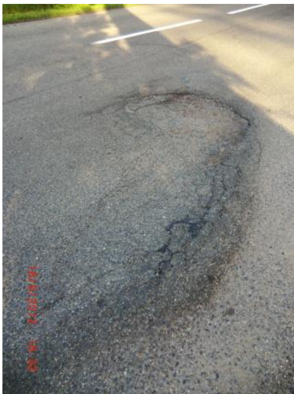
Foto č.32 – výtluk, síťová trhлина (km 0,632)
