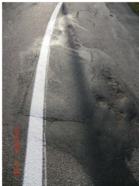
Foto č.25 – porušení v oblasti vysrávky (km 0,503)
