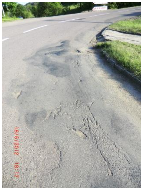
Foto č.21 – podélné trhliny, vyspráva, hloubková koroze, výtluky (km 0,480)
