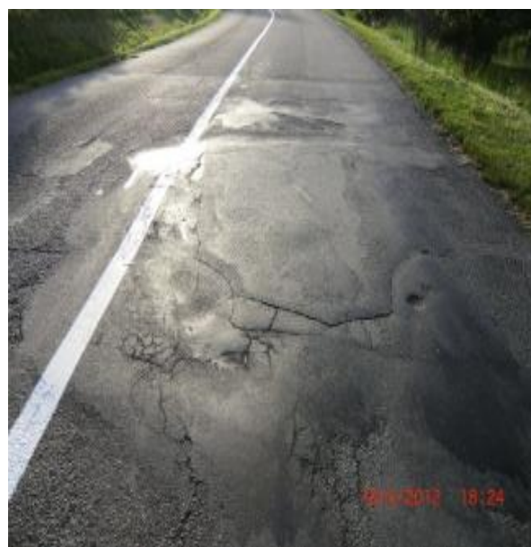
Foto č.27 – vysrávky, síťové trhliny (km 0,515)
