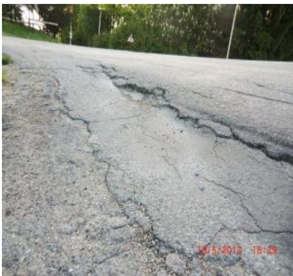
Foto č.30 – odlamování krajnice (km 0,591)
