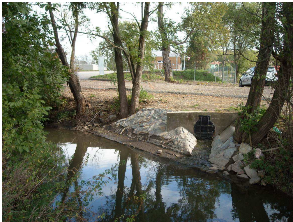
Obr. 15: Vyústění potrubí z ČOV Rebešovice km 2,125
