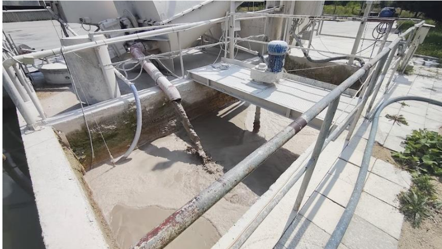
Obr. 4 Nádrž na kalovou vodu ZAPA beton Holubice
