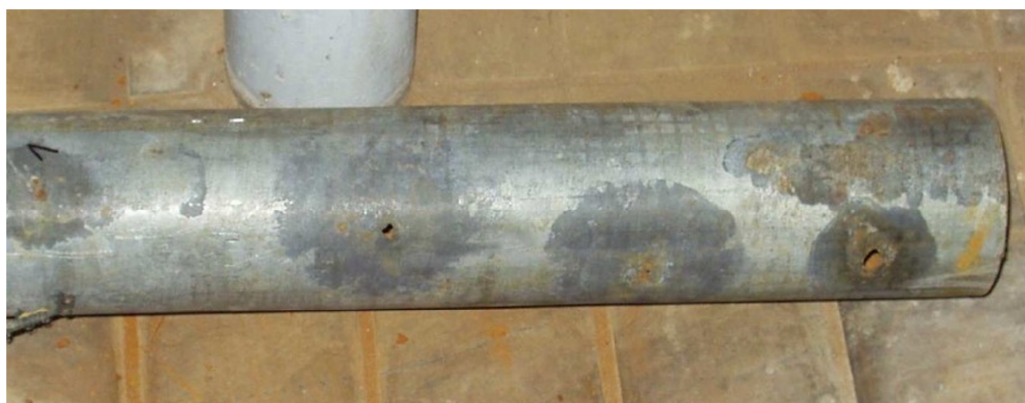
Obrázek 9 Pozinkovaná ocelová trubka poškozená důlkovou korozí [12]
