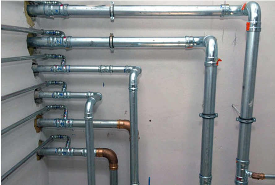
Obrázek 10 Rozvody z nerezových ocelových trubek [13]
