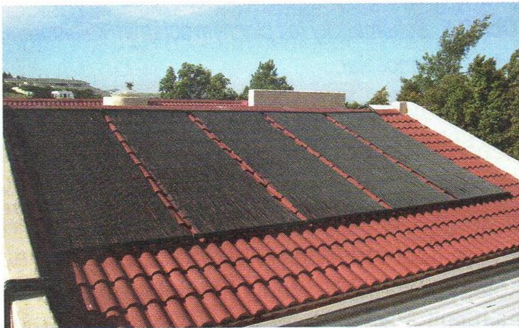
Obrázek A-6 Nekryté kolektory (6)
