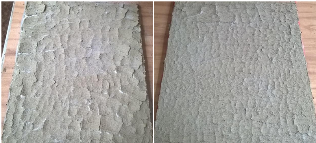
Obrázek 23: Vlevo popraskaná druhá vrstva se zametenými prasklinami křemenným pískem na fólii DEKTEN PRO PLUS, vpravo popraskaná druhá vrstva se zametenými prasklinami křemenným pískem na fólii DEKTEN MULTI-PRO.
