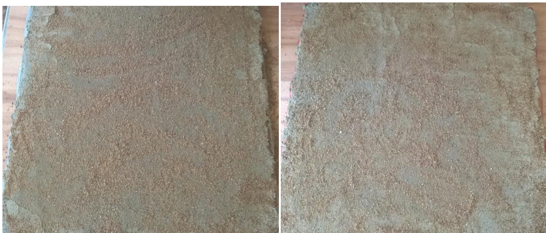
Obrázek 24: Vlevo popraskaná třetí vrstva s posypanými prasklinami upraveným DTK frakce 0–2 mm na fólii DEKTEN PRO PLUS, vpravo třetí vrstva se zametenými prasklinami upraveným DTK frakce 0–2 mm na fólii DEKTEN MULTI-PRO.
